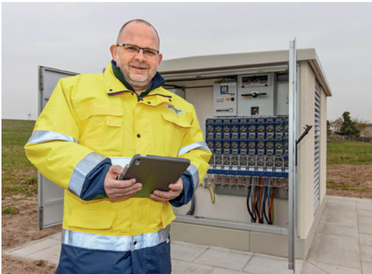
Mathias Fett, Abteilungsleiter Bereich Netze, an einer der neuen Trafostationen. 2026 werden weitere dieser Ortsnetzstationen fit für die Zukunft gemacht.
